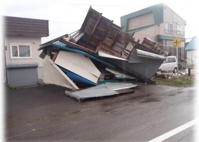
【9月5日台風21号による建物倒壊（倶知安町）】
